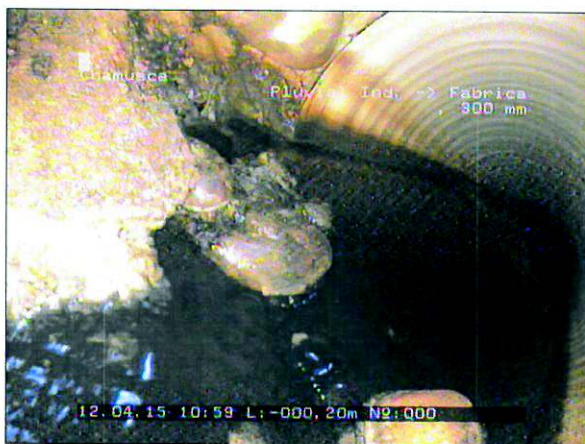
fotografia: 2b, Vídeo nº: 01, 00:00:24 -0,2m, Inspeção interrompida
