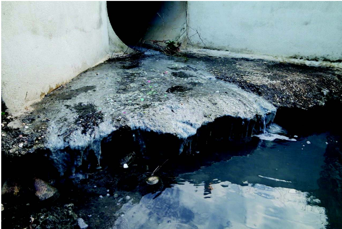
Foto 4 - Aspecto da boca de lobo da rede pluvial
