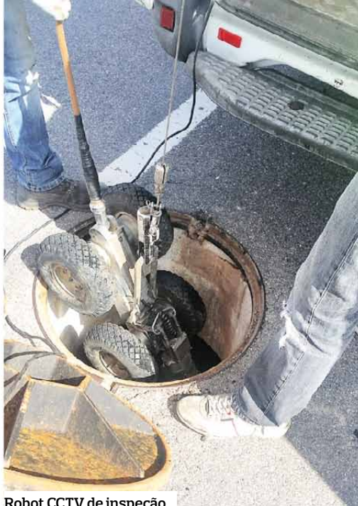
Robot CCTV de inspeção
